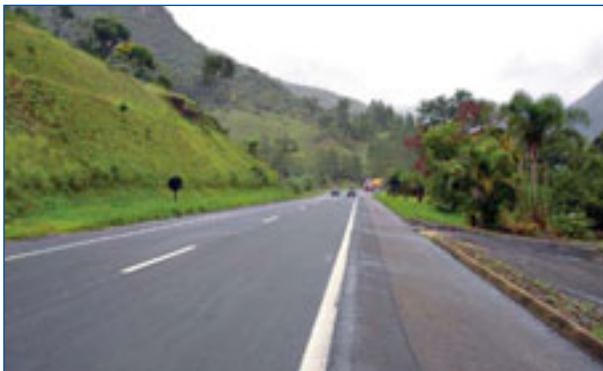
Foto 2 – km 514+800 – Rampa descendente antes da curva nº 2
