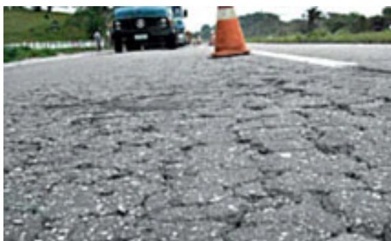
Fig. 02 – Trincamento e tráfego elevado na pista experimental
